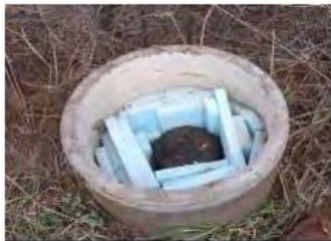
給水栓ボックス内の保温状況
