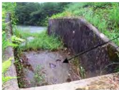
洪水吐底板（コンクリート）の欠損
