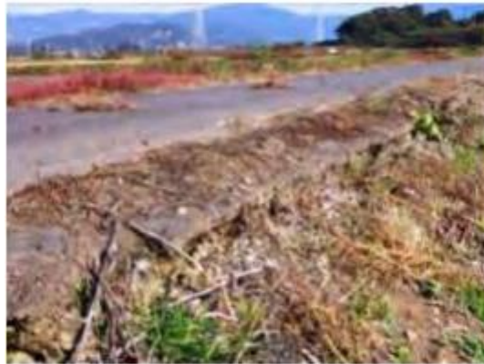
路肩の侵食と路面下の空洞
