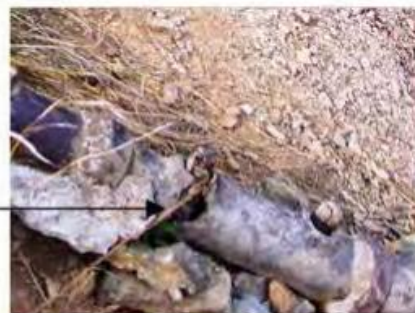
古い樋管（陶製）の破損
