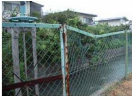
破損した金網フェンス
