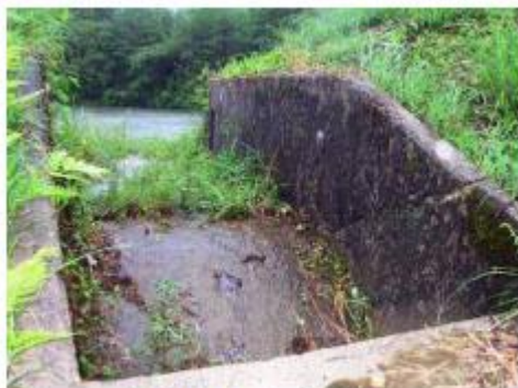
老朽化した洪水吐
