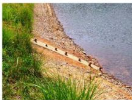
老朽化した取水施設
