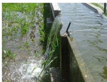
水路からの部分的な溢水
