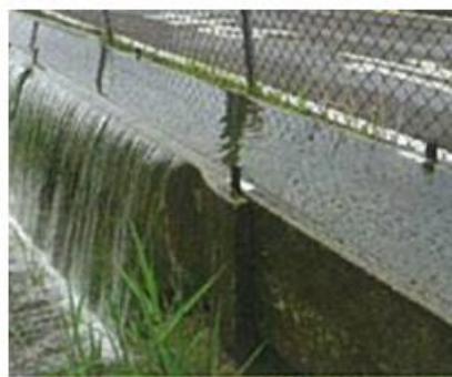
水路からの溢水
