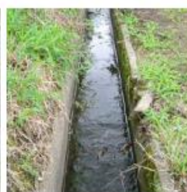
部分的な欠損
