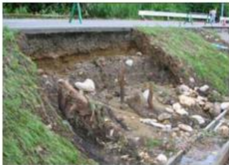
道路法面の崩壊
