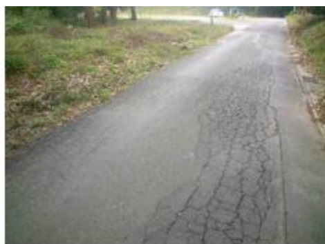
アスファルト舗装の 老朽化
