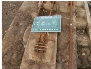
ため池における 老朽化したゲート
